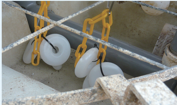
冷却塔の中にある消音ネットの設置ツテに、スケールが付着しています。（白くなっている部分）
