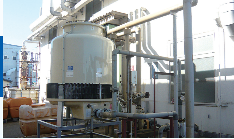
この冷却塔の地下に20m 3 のタンクがあります。
