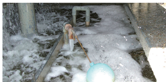
▲水質が汚染されている状態
